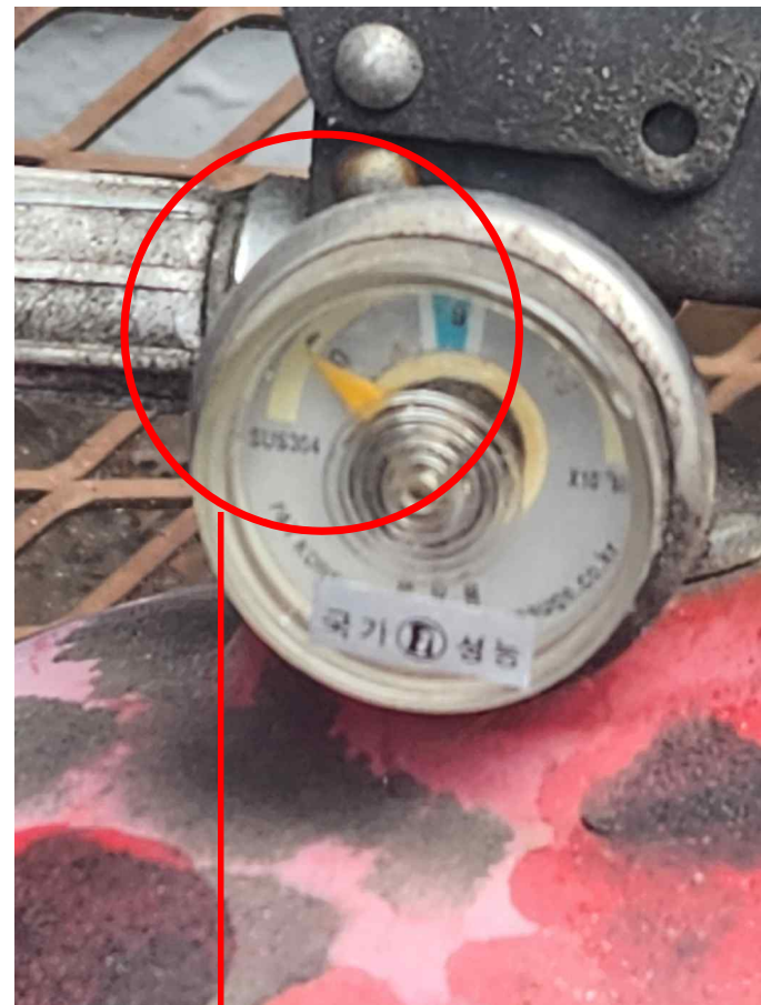
→ 소화기 압력 부족
