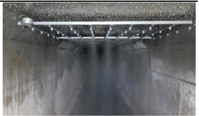
악취저감시설 설치 후
