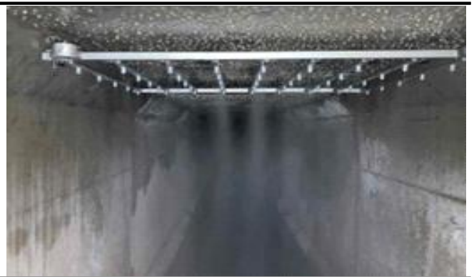
악취저감시설 설치 후
