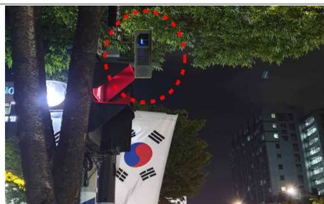
횡단보도 음성안내시스템 설치
