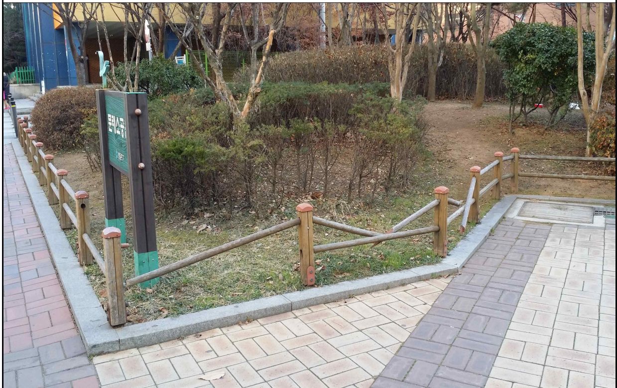
현황사진(파손된 녹지 헨스 및 나대지)
