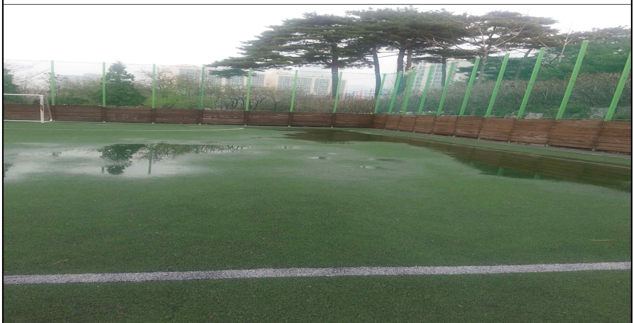
현황사진(풋살경기장 - 노후, 침하에 따른 물고임, 고무칩 돌출)
